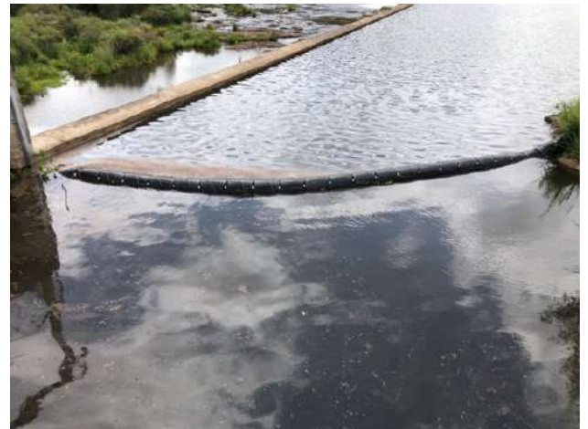
Figura 21 – Tomada de água e log boom
