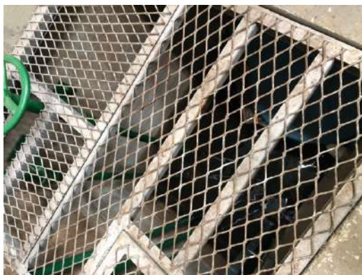
Figura 34 – Poço de drenagem e caixa separadora de água e óleo na casa de máquinas
