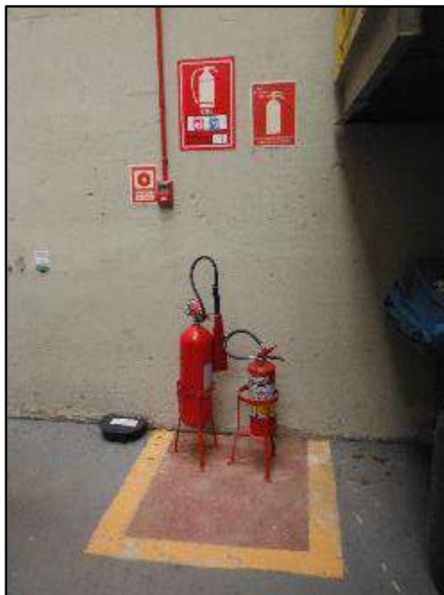
Figura 12 – Extintores de incêndio, mantidos no interior da casa de força, próximos às turbinas.
