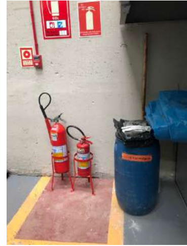
Figura 33 – Extintores, alarme e kit de emergência ambiental na casa de máquinas
