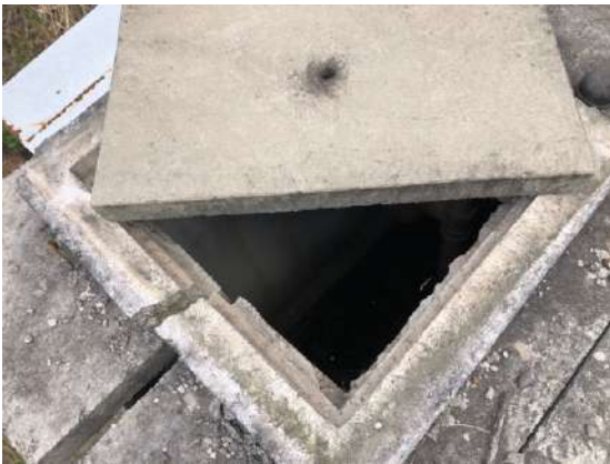
Figura 28 – Caixa do tanque da subestação
