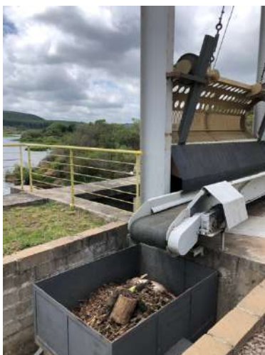
Figura 24 – Limpador de grades e caixa de resíduos
