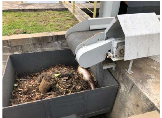
Figura 23 – Caixa de resíduos do limpador de grades
