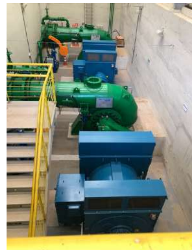
Figura 31 – Casa de máquinas
