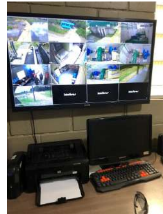
Figura 35 – Sistema supervisorio na casa de máquinas
