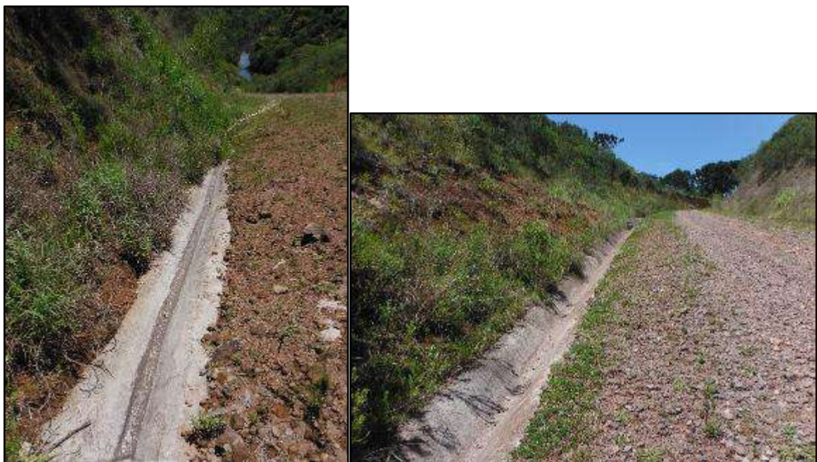
Figura 5 - Sistema de drenagem instalado ao longo do empreendimento, em excelente condições de manutenção.
