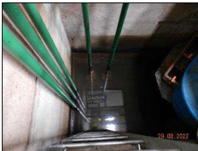
Figura 6 – Caixa Separadora de Água e Óleo (CSOL).
