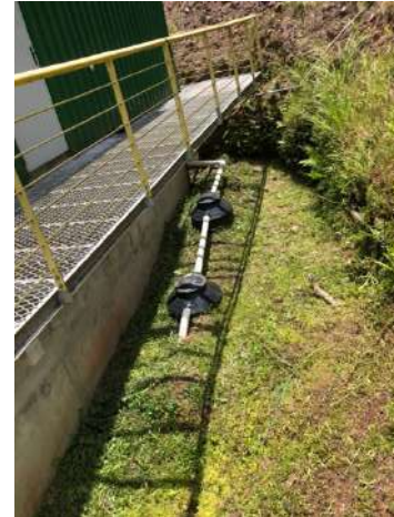
Figura 39 – Sistema de fossa, filtro e sumidouro dos banheiros
