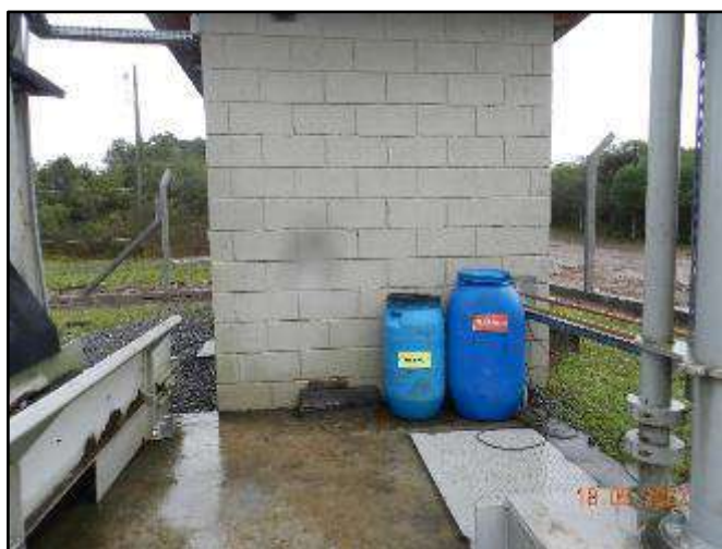
Figura 8 – Recipientes utilizados para acondicionamento dos resíduos resultantes do limpagrades.
