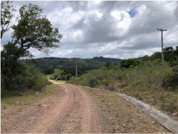
Figura 20 – APP, estrada de acesso e canaletas de drenagem.
