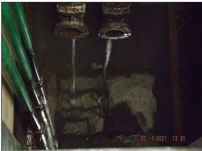
Foto 14: Caixa de drenagem da PCH Cazuza Ferreira.
