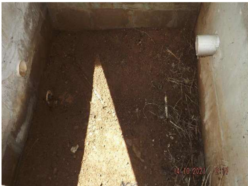
Foto 6: Bacia de contenção de óleo da subestação sem presença de óleo.
