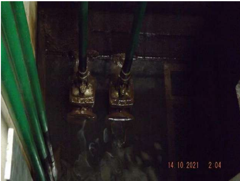
Foto 4: Poço de drenagem da PCH Cazuza Ferreira.
