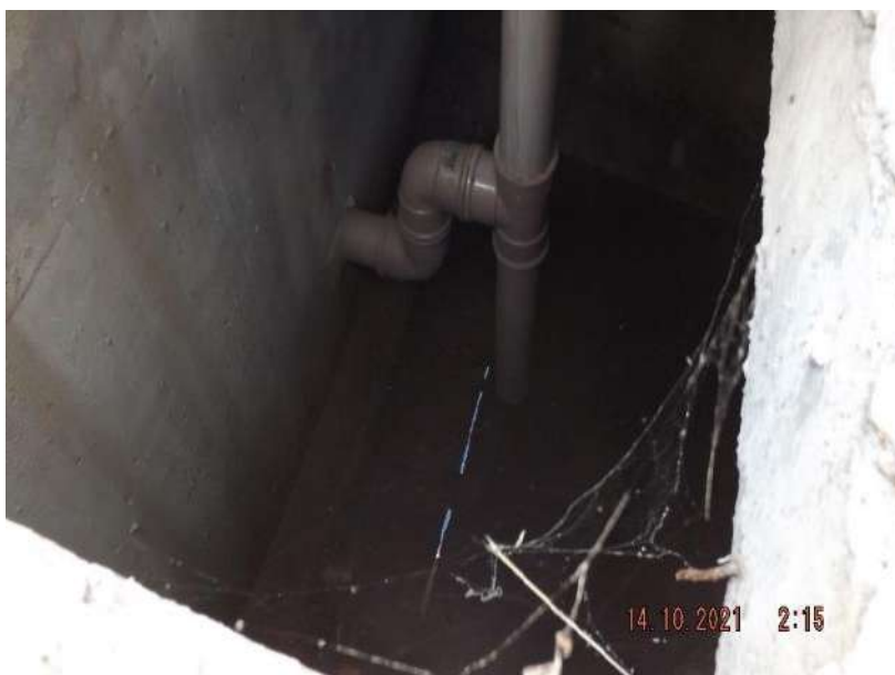
Foto 7: Bacia de contenção de óleo do transformador da subestação.
