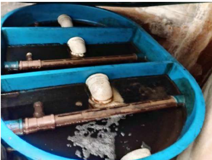
Foto 5: Caixa separadora de água e óleo da PCH Cazuza Ferreira.
