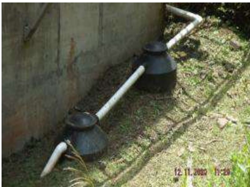
Foto 3: Fossas sépticas instaladas na casa de força.
